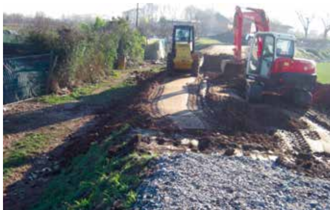
Foto 4 - Chiusura breccia di monte: formazione del nuovo tratto di rilevato, per strati successivi compattati
